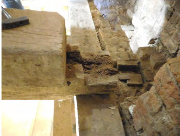
Zerstörte Holzkonstruktion in der Glockenstuhlebene
