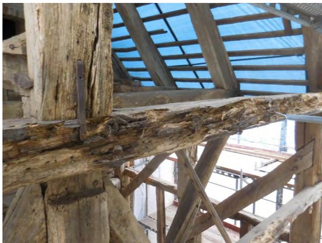
Diverse Schäden in der Tragkonstruktion
