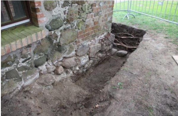
Abb. 17: Gründungsschäden durch Wurzelwuchs
