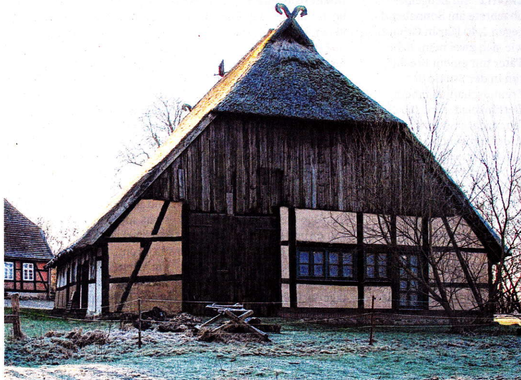
Mitte des 18. Jahrhunderts wurde die Pfarrscheune gebaut. Damit sie als Freizeittreff, Winterkirche und Hörspielscheune genutzt werden kann, muss sie saniert werden. Im März geht es los. FOTOS: TAKEN
