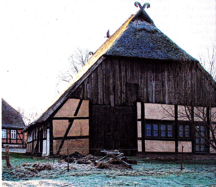
Mitte des 18. Jahrhunderts wurde die Pfarrscheune gebaut. Damit sie als Freizeittreff, Hörspielscheune genutzt werden kann, muss sie saniert werden. Im März geht es los.
